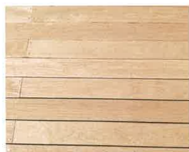
リビングの床材に隙間
