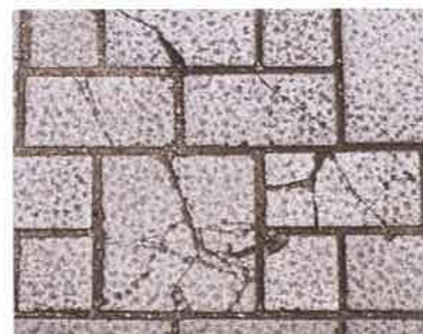
玄関ポーチ 土間タイルひび割れ
