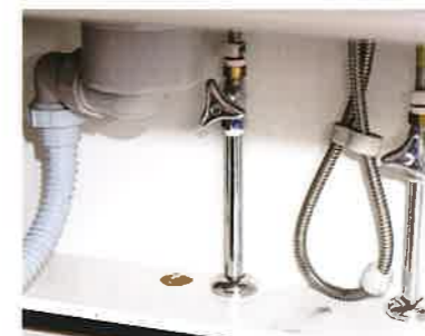
洗面所の水漏れ
