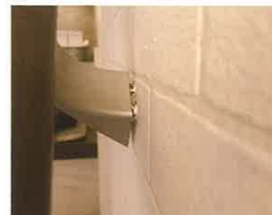
階段手すりの金具が抜けている
