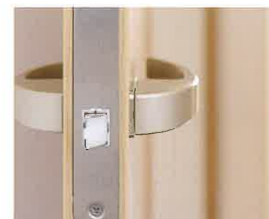
ドア ラッチ部分の動作不良
